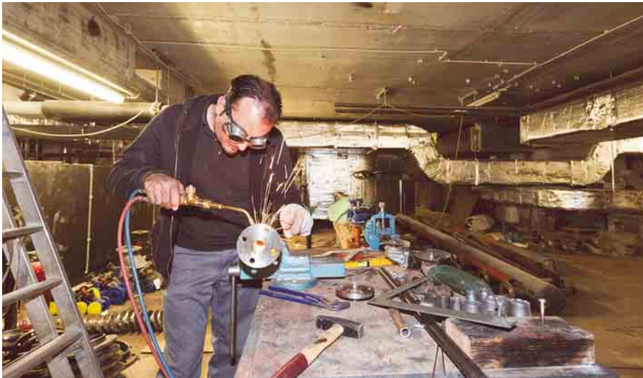
Im Zwischengeschoss über den Operationssälen wurden vor allem große Lüftungsanlagen mit Hochleistungsfiltren installiert.
